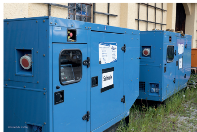
Die Gemeinde schaffte zwei Notstromaggregate an, die im Falle eines Brown- oder Blackouts zum Einsatz kommen werden.
