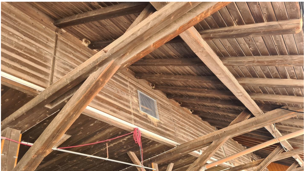
Abb. 15: Spuren ehemaliger Nester der Mehlschwalbe im Bereich des hölzernen Vordachs im Bereich der Nordfassade des südlichen Hauptgebäudes.
